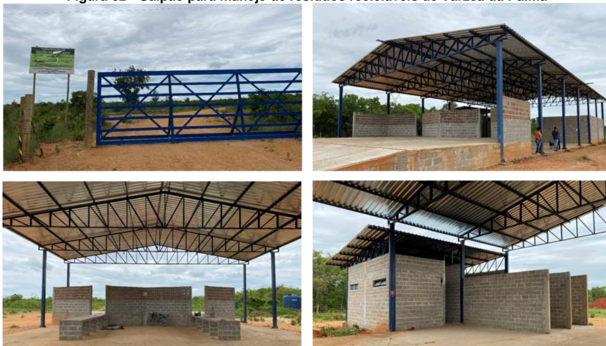
Figura 62 - Galpão para manejo de resíduos recicláveis de Várzea da Palma
