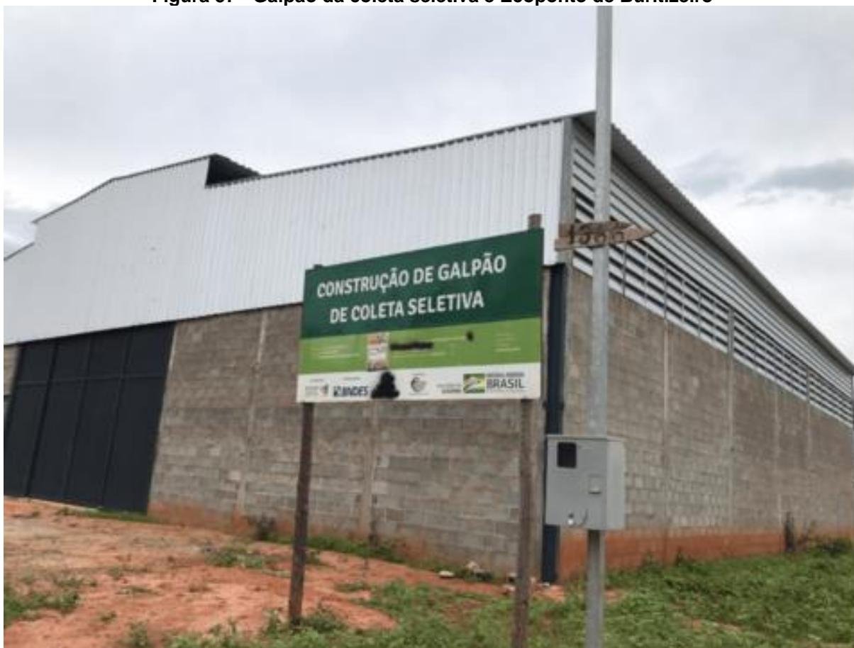
Figura 57 - Galpão da coleta seletiva e Eco ponto de Buritizeiro
