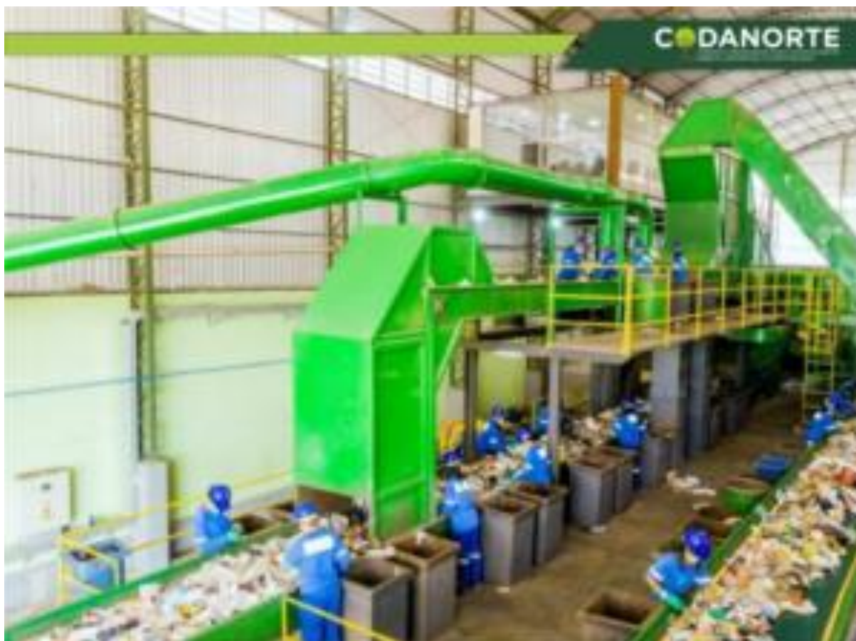
Figura 8 – Modelo de Usina de Triagem mecanizada – UTM
