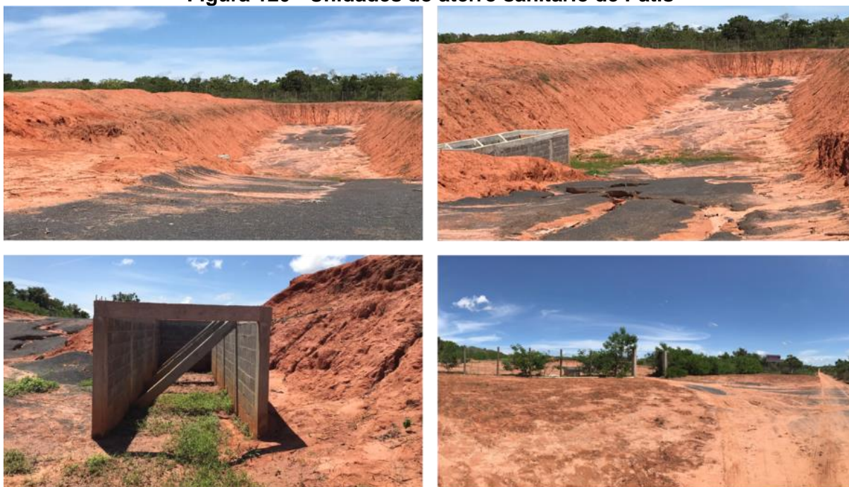
Figura 120 - Unidades do aterro sanitário de Patis
