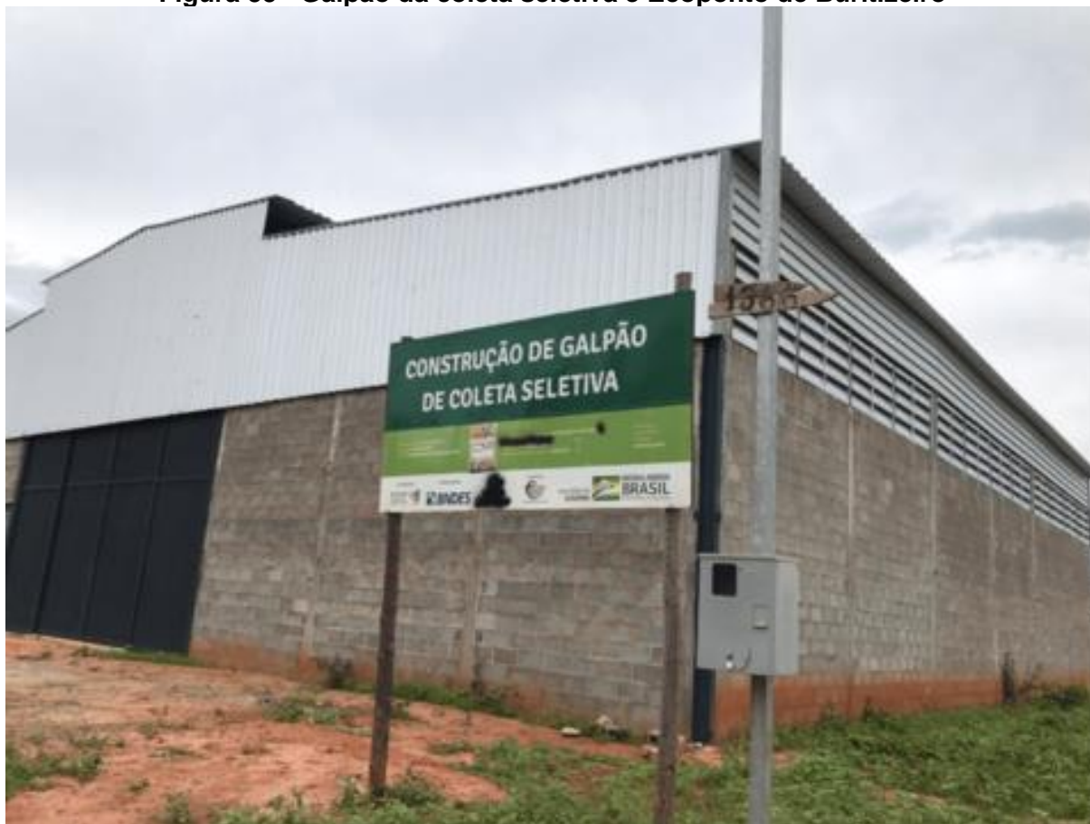
Figura 55 - Galpão da coleta seletiva e Ecoponto de Buritizeiro
