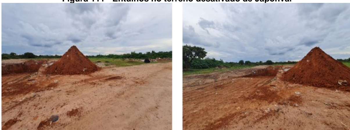
Figura 111 - Entulhos no terreno desativado de Japonvar
